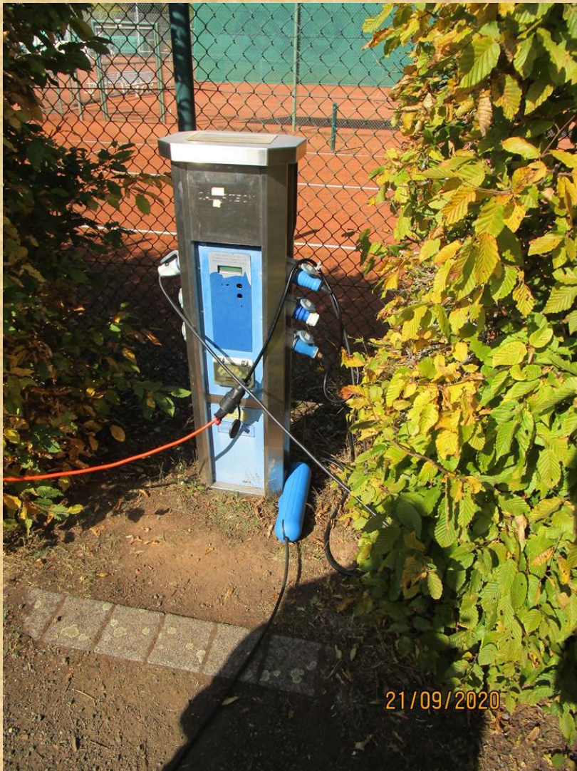
Defekte Stromverteilung IST- Situation auf Platz 2 (UNZULÄSSIG)
